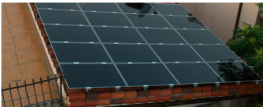
图5.5 坡屋顶屋顶安装的光伏组件（北京）
