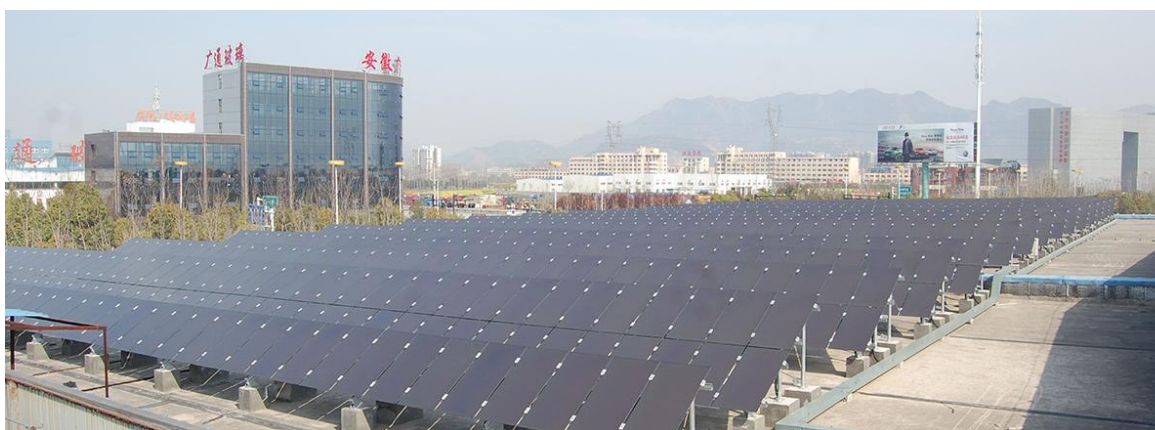
图5.13 间隔一定距离分组安装的光伏组件
