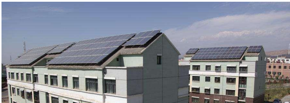
图5.14 连续倾斜安装的光伏组件，难以清洗维护
