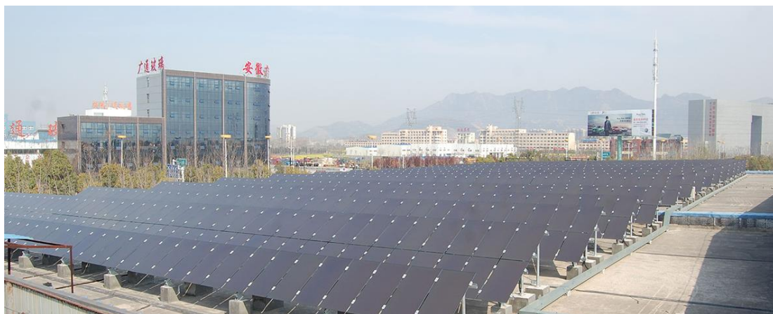
图5.6 平屋顶安装的光伏组件（安徽安庆）
